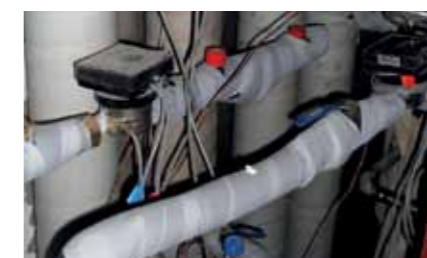
Des vannes d'équilibrage Danfoss ASV et des compteurs d'énergie ont été prévus dans la salle technique par groupe de quatre appartements.
