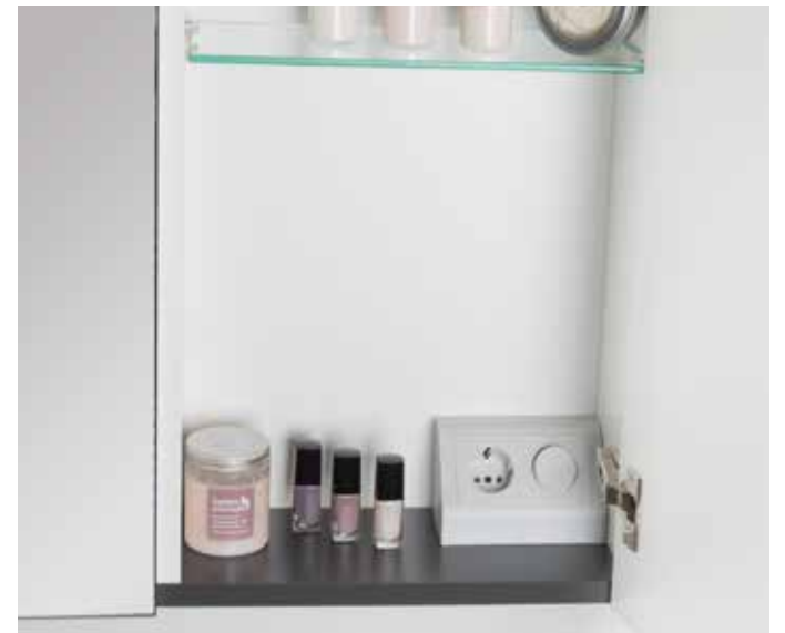
Integrierte E-Box mit Schalter und Steckdose im Schrankinneren rechts
